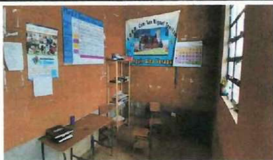
Foto1: Se evidencia la necesidad de aplicación de repello, debido que se encuentra en mal estado
